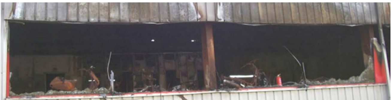
Brandschaden durch korrosive Gase
