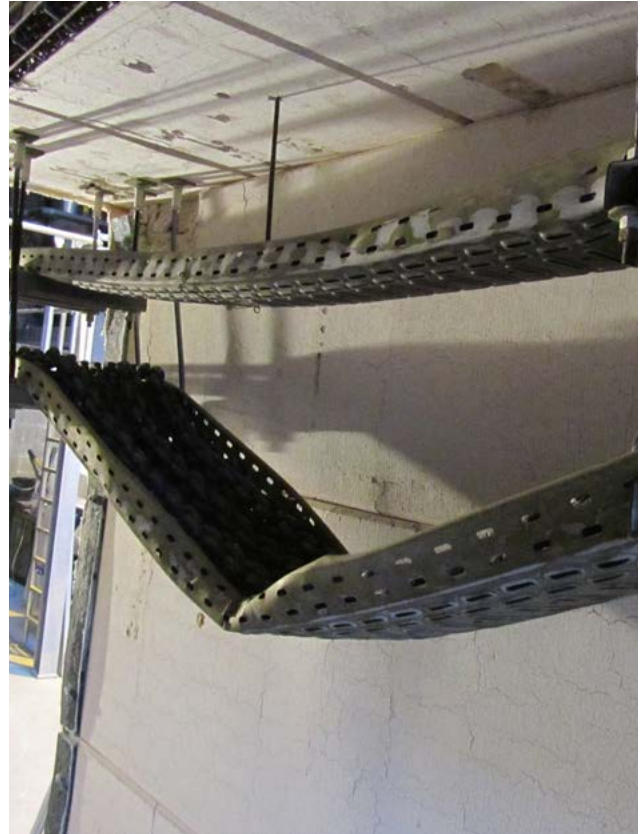
...und nach der Brandprüfung
