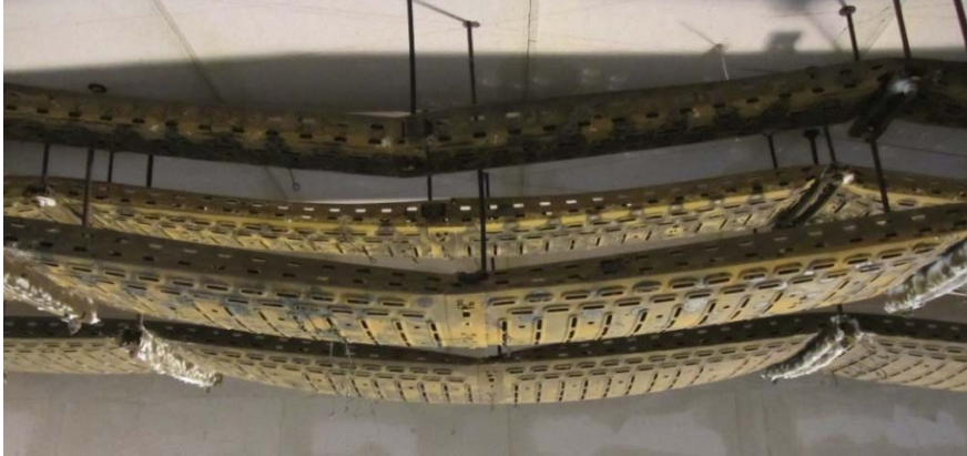
Bild 4: Verformte Kabelrinnen nach der Brandprüfung (Brandbeanspruchung 90 Minuten)
