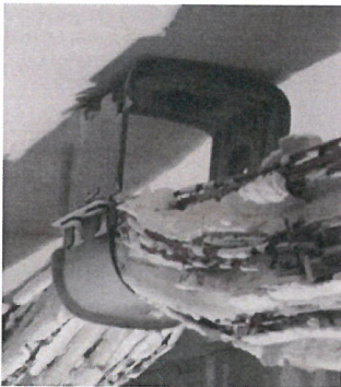
Bild 2: Verformung bei Deckenmontage
