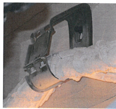
Bild 3: Verformung bei Wandmontage
