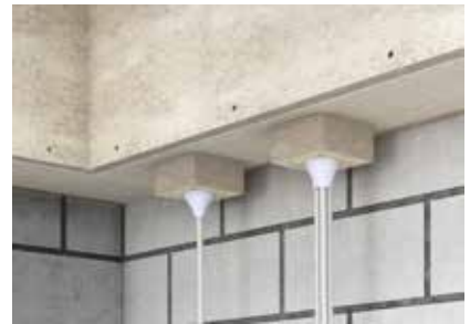
Montierter Brandschutzkanal mit Kabelausgängen
